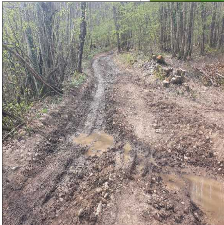
Nécessité d'aménager un renvoi d'eau
