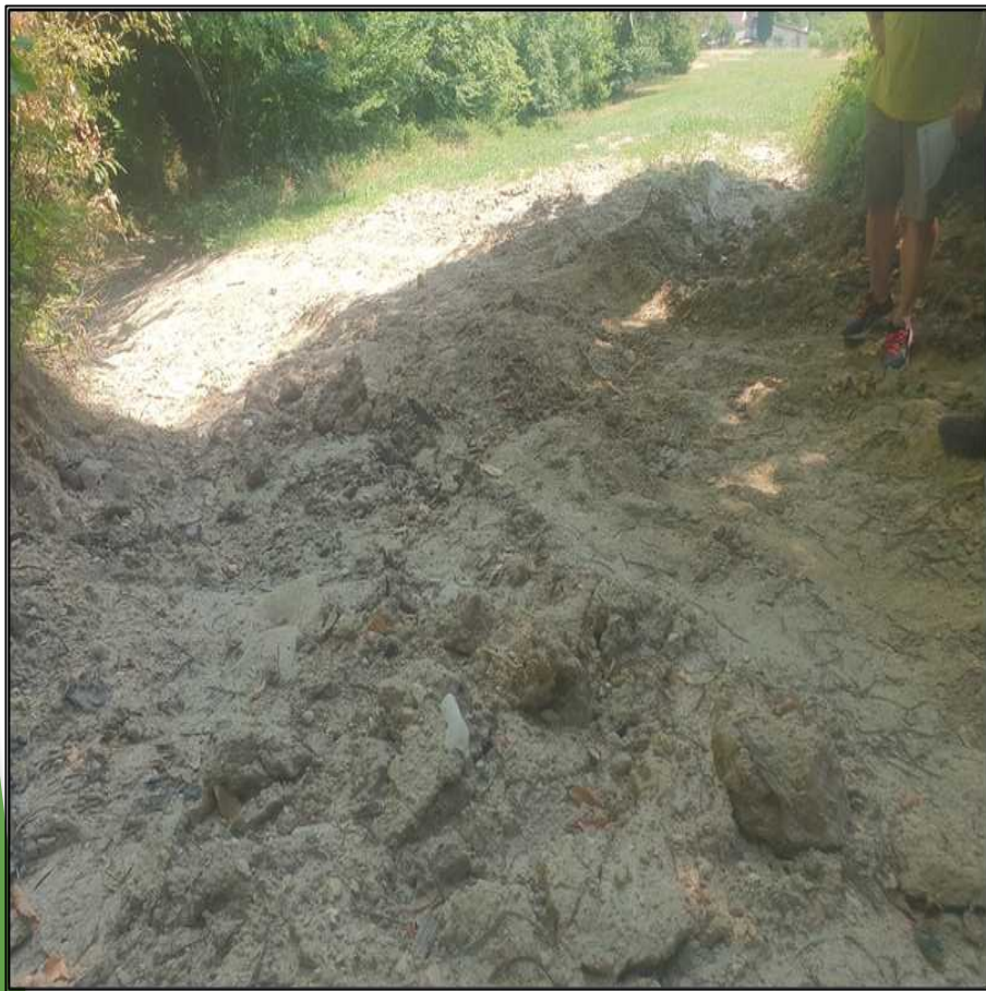
Un renvoi d'eau à remettre en état
